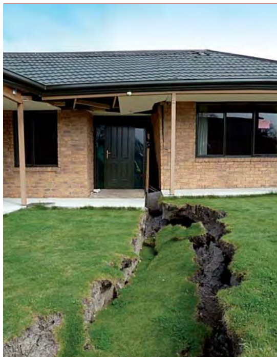
Figura 10: Ejemplo de los daños irreparables a una vivienda en un barrio periférico de la zona este debido a un desplazamiento lateral (fotografía de Tonkin & Taylor Ltd).
